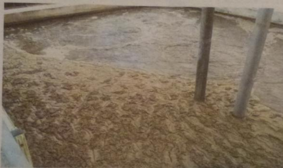
Les boues rouge se forment à la surface de l'eau de la station d'épuration, détruisant la biomasse. PHOTO SIAEP
